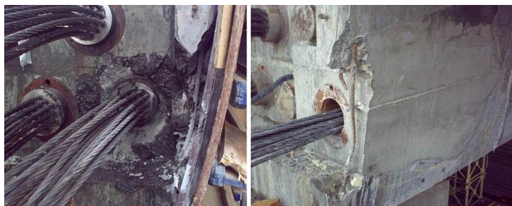
Rys. 23. Przykład uszkodzeń strefy zakotwień przed i po programie naprawczym (źródło: publikacja nr 7)
